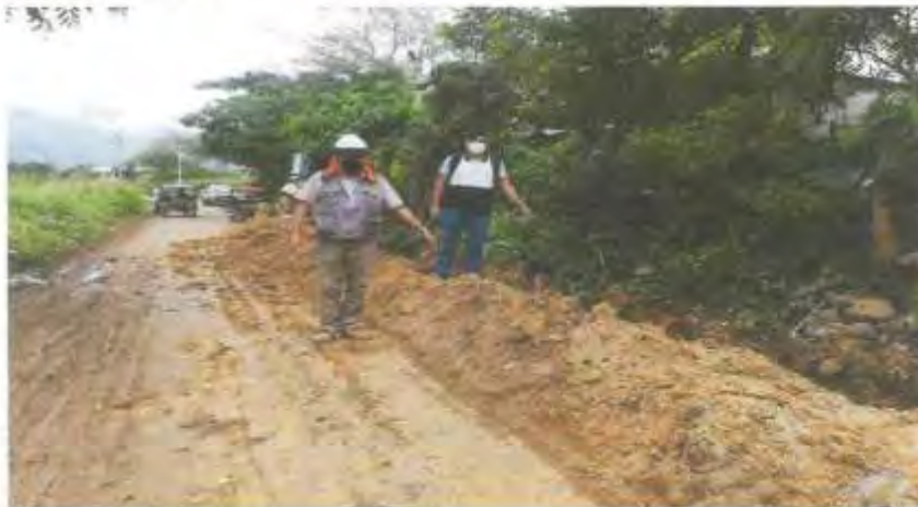
FOTOGRAFIA N° 18.- Ing. Residente verificando colocación de tubería de agua juntamente con el Supervisor - Tramo II
