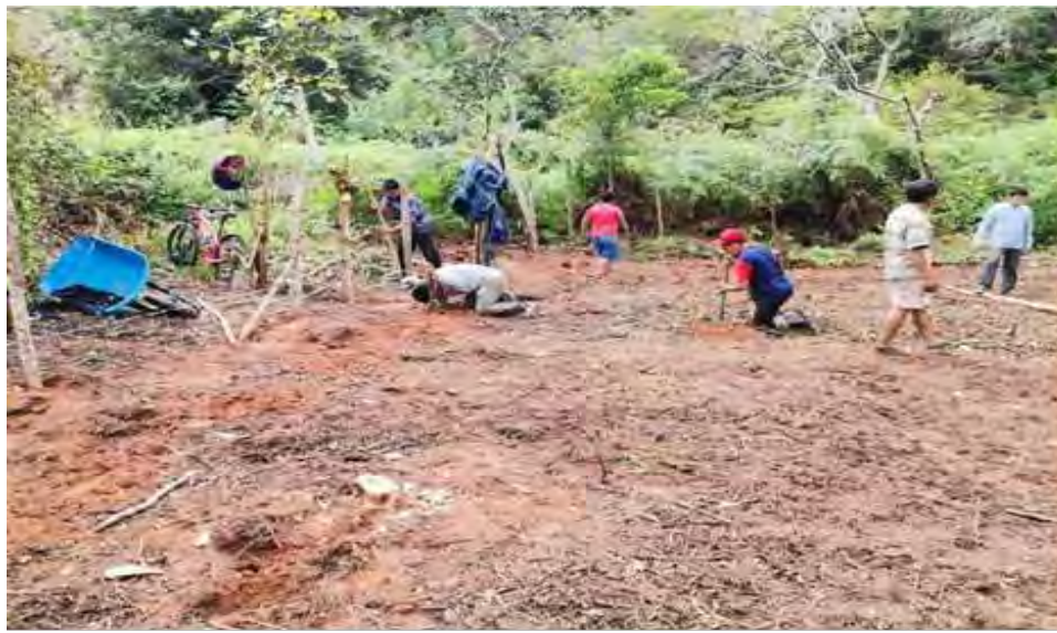
FOTO 03: Cerco perimétrico y tinglado Instalado para la protección de la producción de plantones (C.P. Rumibamba, D. Las Pírias)
