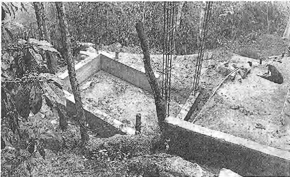
Se aprecia la ejecución de la partida de sobre cimientos de uno de los módulos. UBS del Agua Potable Las Delicias
