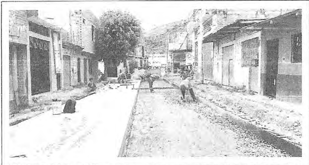
FOTOGRAFÍA 39 : Verificación de espesor de losa y encofrado de la Calle Unión cdr. 01.
