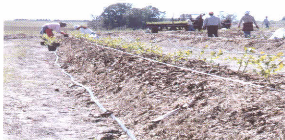
Mantenimiento del sistema de riego
